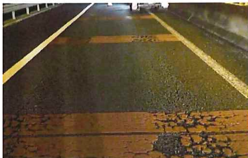
舗装損傷状況
