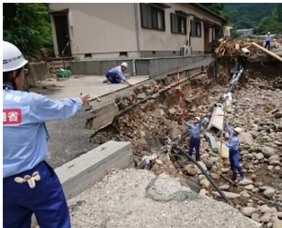
河川被害状況の調査
