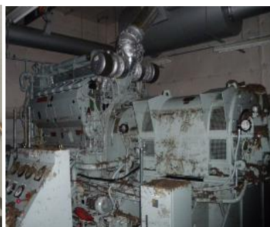
航空保安施設用予備発電設備の調査
