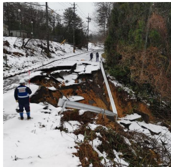
道路被害状況の調査
